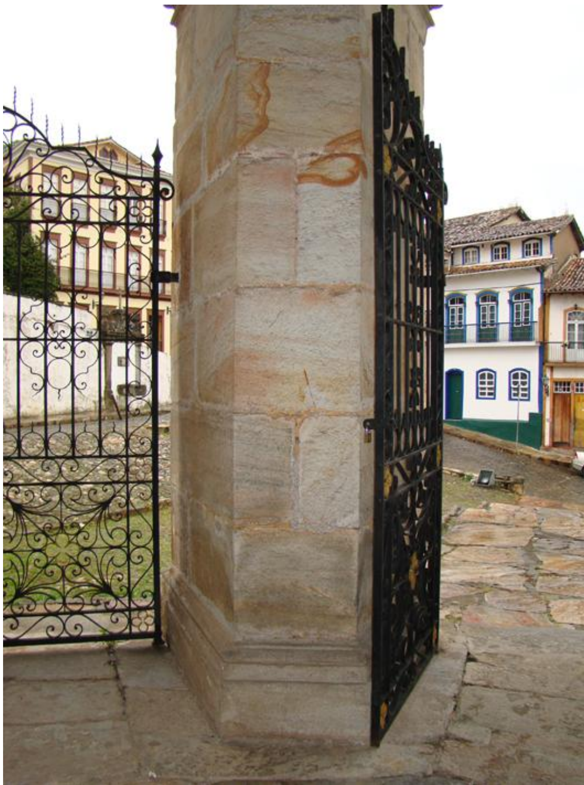
Capítulo 4 – Figura 76A: Chanfro evitando o ângulo agudo no nártex da capela de N. Sra. Rosário dos Negros de Ouro Preto, M.G., (foto do autor).
