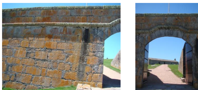
Capítulo 7 - Figuras 156 e 157: Arco rebaixado vazando Muro em Talude, Fortaleza S. Teresa, Uy. (foto do autor).
