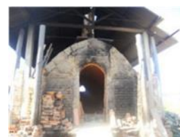
Figura 24452 - Área interna do forno
