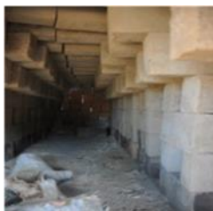
Figura 158 - Paredes internas do forno
