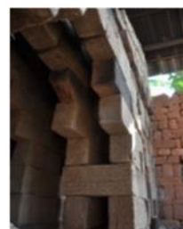
Figura 164 - Parede de sustentação da laje do forno
