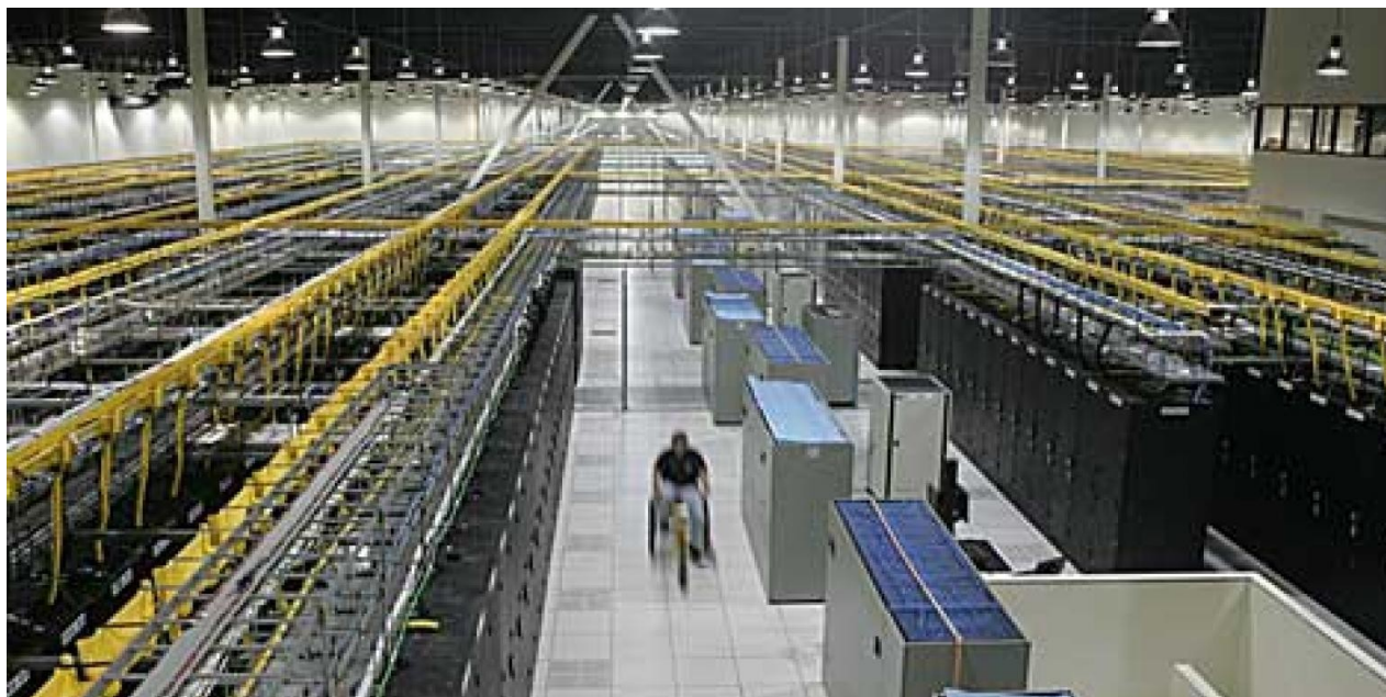
Fig. 4.3: Data center da QTS em Suwanee, Georgia
